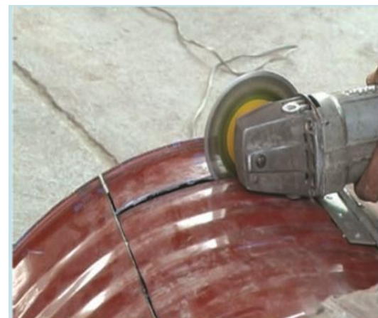
12. เมื่อเจาะยึดบานพับ 3 อัน จึงสามารถตัดด้านข้างของช่องเปิดได้
