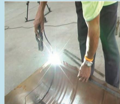
17. ในส่วนของเตาย่าง ให้นำเหล็กเส้นแบนมาเชื่อมกับขอบถังด้านใน โดยรอบให้มีระยะห่างจากขอบถัง 1 ถึง 2 เซนติเมตร
